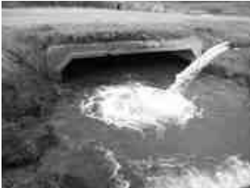
Rejets d'eaux usées sans traitement dans une rue
