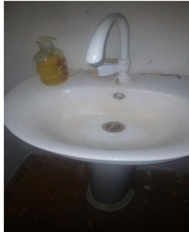
Station de lavage des mains après CCM, Wetet Abay HC/Photo personnel CRS
