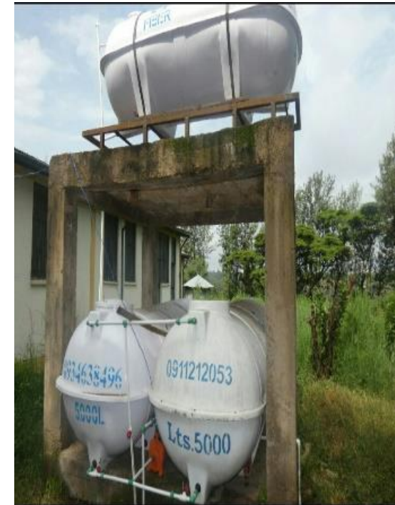
Infrastructure d'eau après la CCM, Wetet Abay HC/Photo personnel CRS
