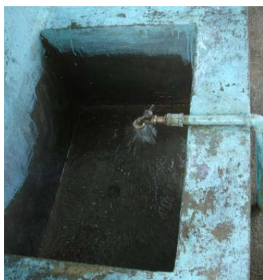
Foto 4 Llave dañado y goteando en una de las pilas escolares
